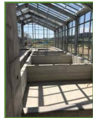
Construction des bassins en béton du bâtiment principal sous une couverture entièrement en verre
