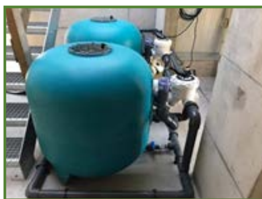
Filtration centralisée pour les bassins intérieurs en béton (sable et traitement UV)
